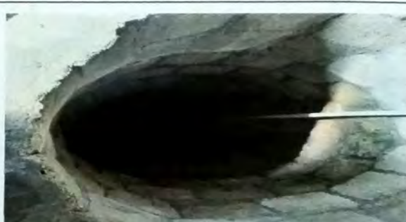
Foto 12: POZO DE ABASTECIMIENTO DE AGUA Se debe de profundizar mas para elevar en nivel freatico, actualmente posee 6.0 mts, ya no es suficiente para la demanda de la escuela-
