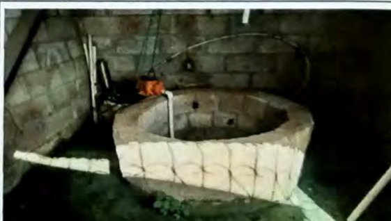
Foto 6: POZO DE ABASTECIMIENTO DE AGUA Se debe de profundizar mas para elevar en nivel freatico, actualmente posee 6.0 mts, ya no es suficiente para la demanda de la escuela-
